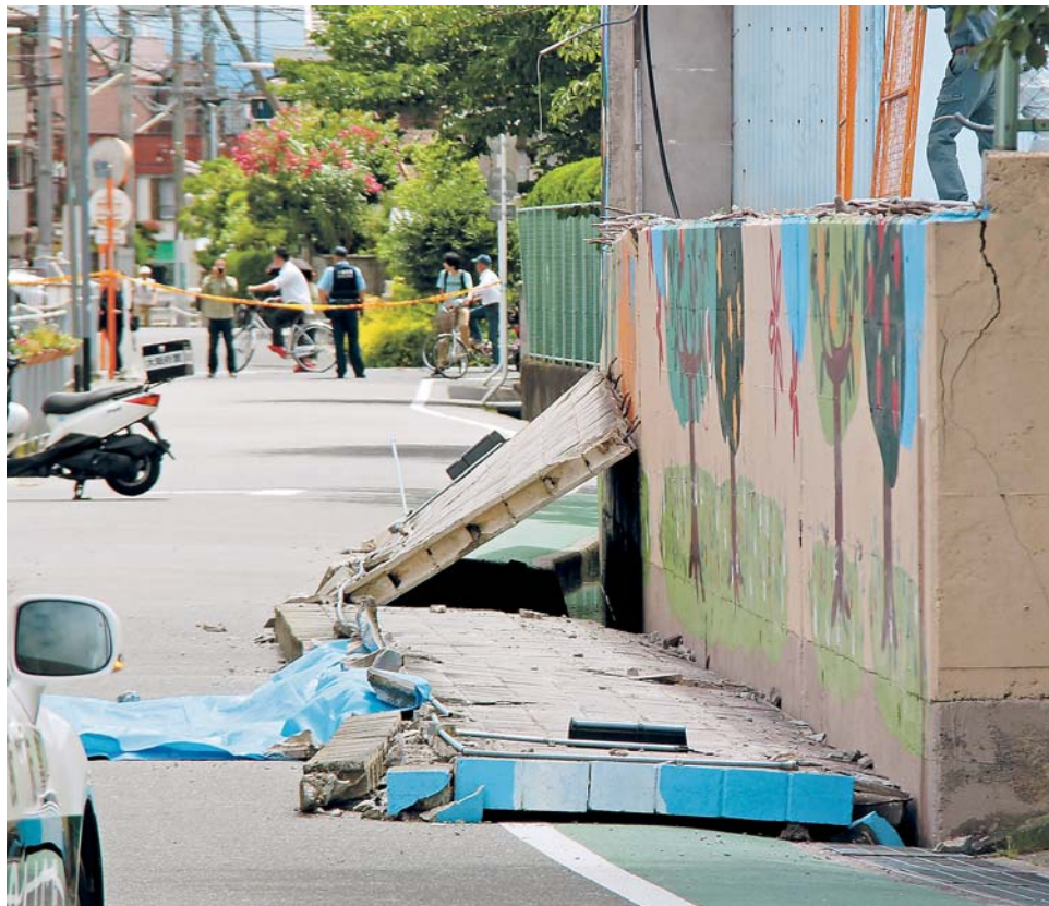
倒壊した大阪府高槻市立寿栄小の壁。18日午前10時56分
